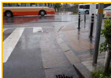
改修前(水たまり発生)
