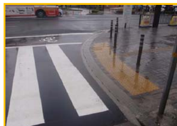
改修後(水たまりなし)
